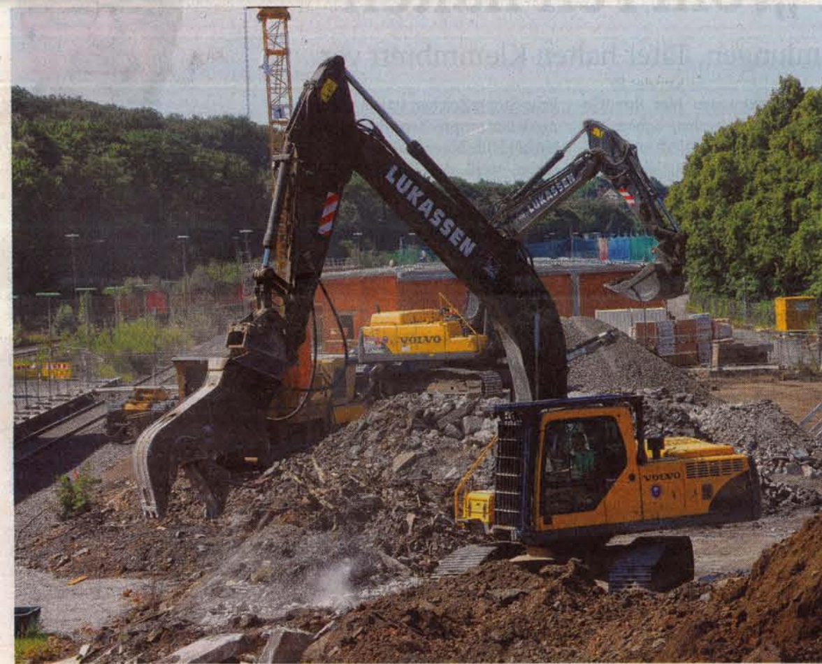
Das ist das Bild dieser Tage im vorderen Bereich des Bahnhofsgeländes: Ein Abbruchunternehmen zerkleinert mit viel Lärm und Staub die Überreste des Bahnhofsgebäudes: Das Material wird an anderer Stelle zum Auffüllen genutzt.
